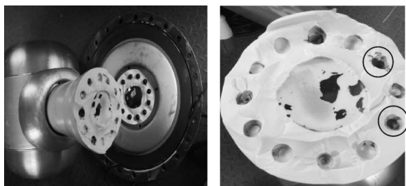
图15 支撑绝缘件内部放电情况
